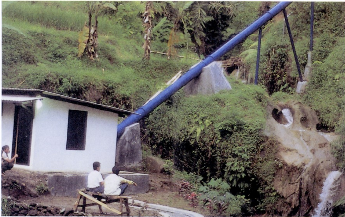
Kleinwasserkraftanlage in Indonesien (Foto: GTZ)
